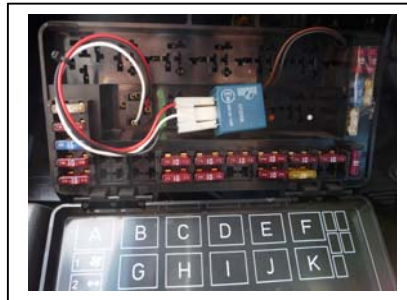
Sicherungskasten mit neuem Modul
