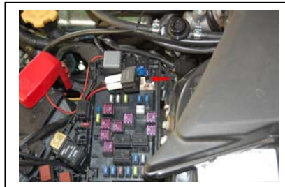
Relais für Ladestrom
