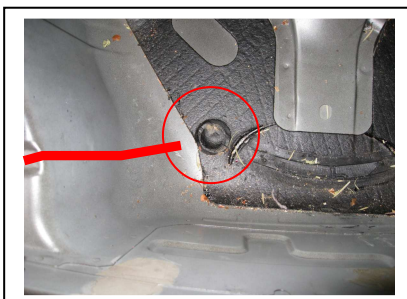
Kabeldurchführung AHK und vorgesehene Verlegeposition.
