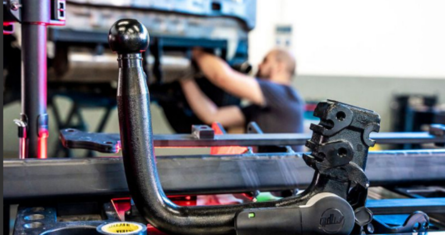
In den 50 hauseigenen Rameder-Werkstätten werden ausschließlich Anhängerkupplungen nachgerüstet. Zusätzlich sind auch mobile Teams in entsprechend ausgestatteten Vans unterwegs, um Nachrüstungen vor Ort zu erledigen. (Bild: Rameder)
