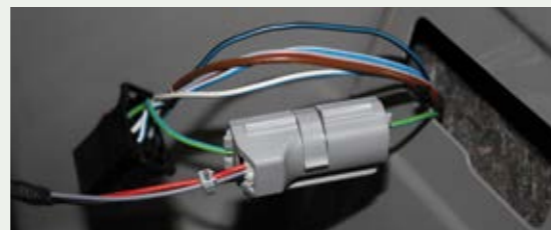
Fertig – die Sensoren sind nun mit dem Steuerteil verbunden und einsatzbereit. Es ist keine Freischaltung / Codierung erforderlich.
