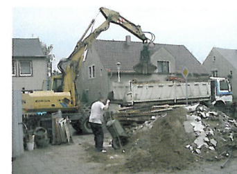
... und der ganze Unrat musste mit schwerer Technik zum Entsorgen gebracht werden.
